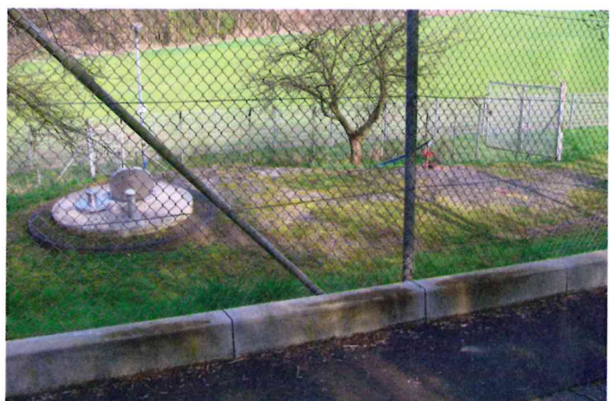
Abb. 4: Anlage eines Hochbords am Zaun zur Wasserschutzzone I zur Entwässerung und Vermeidung von Auswaschungen von Hundekot.
