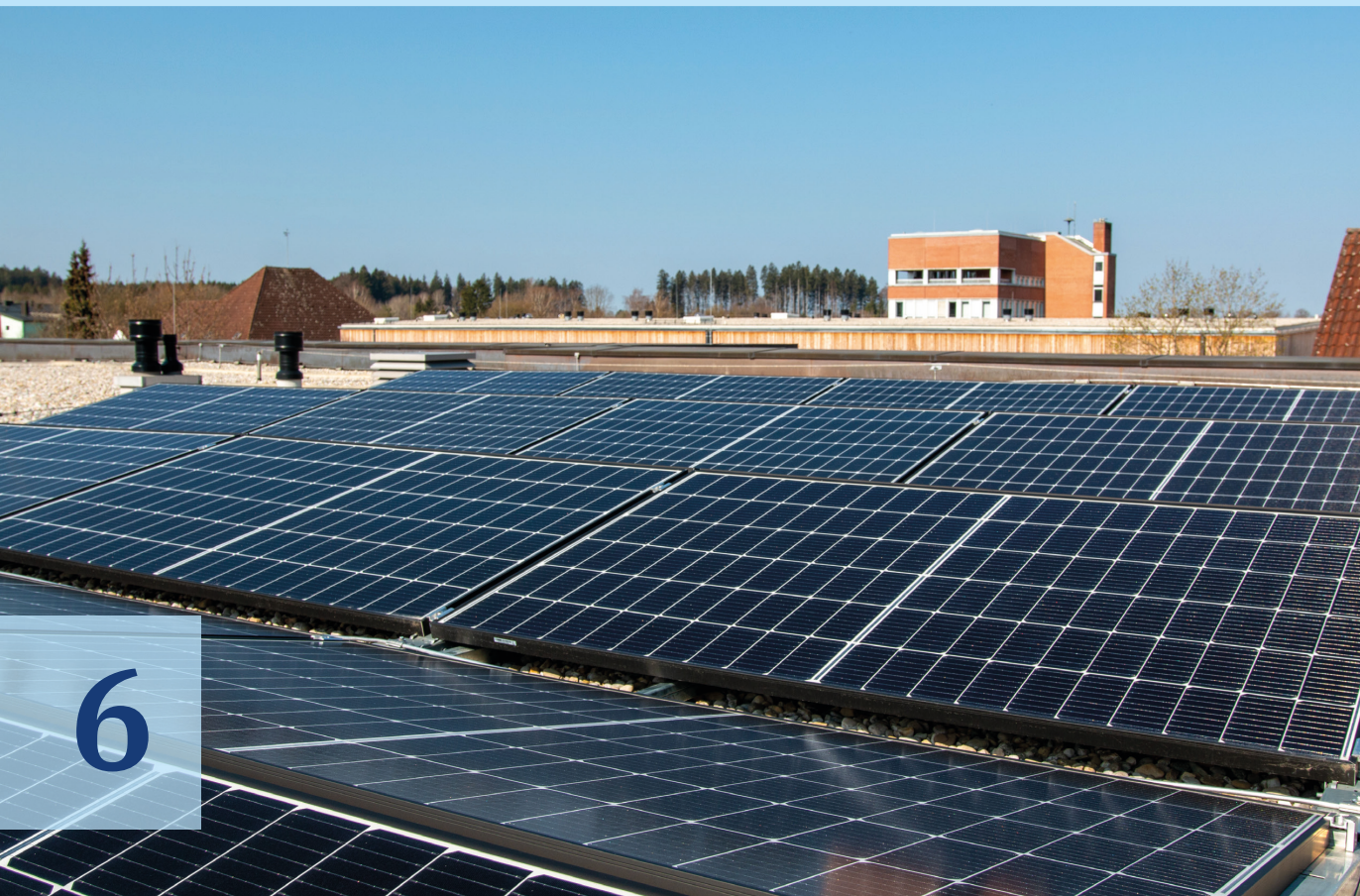
PV Anlage auf dem Dach des Hauses für Kinder in Kirchseeon
